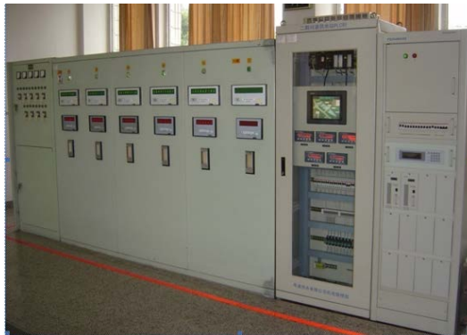
图2 量水间电器仪表室
